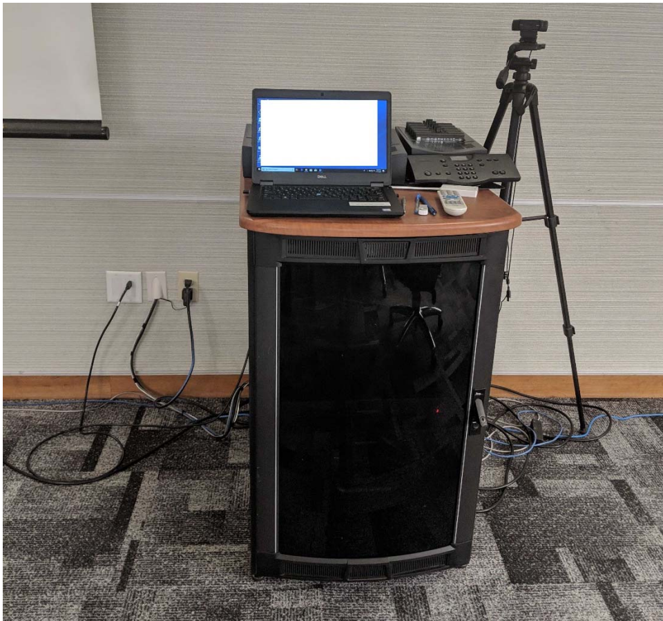
Figure 9 – Existing AV rack
